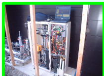
ヒートポンプ機
